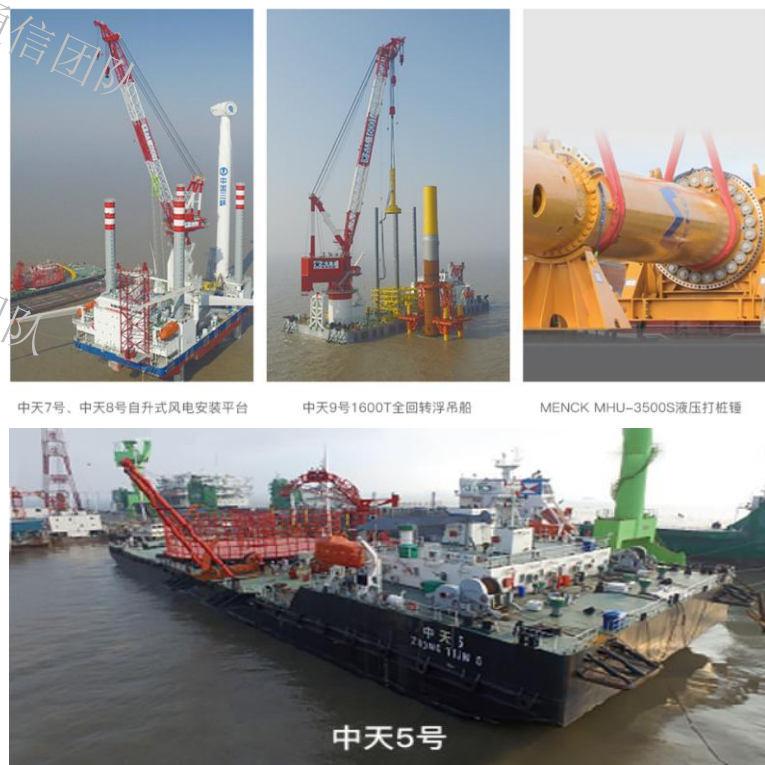
图72：海缆铺设设备
