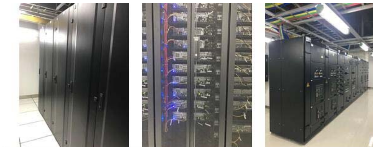
IDC 机房局部图
