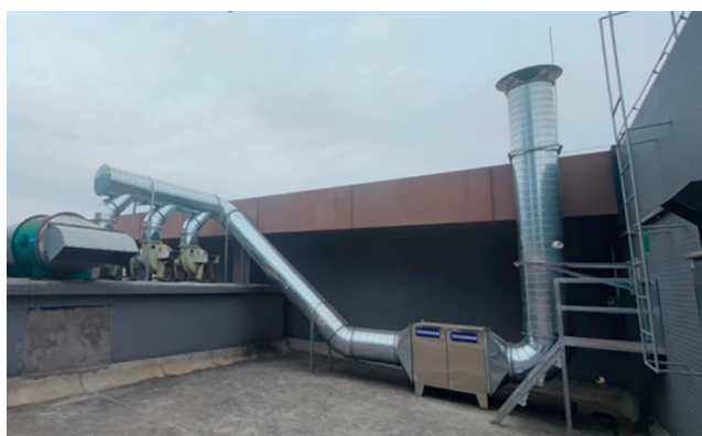
廢氣處置裝置
