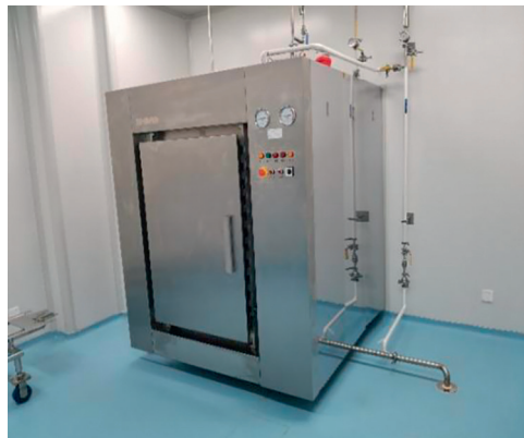
第一類廢渣處理高溫滅菌櫃
