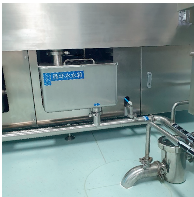
洗瓶機循環水暫存水箱
