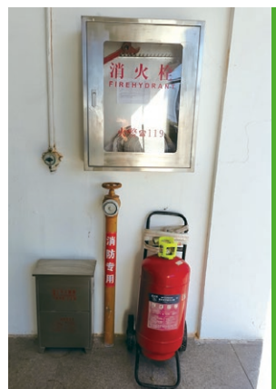
生產車間附近設置 消防器材
